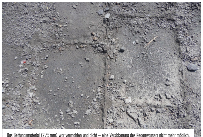
Das Bettungsmaterial (2/5mm) war vermahlen und dicht – eine Versickerung des Regenwassers nicht mehr möglich.
